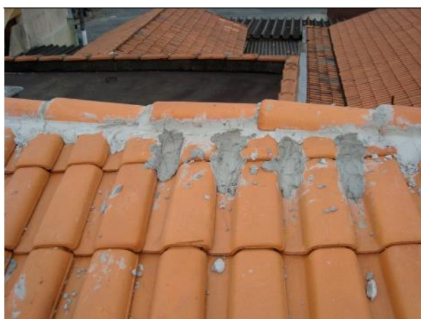
Imagem 02: Excesso de argamassa em Cobertura
